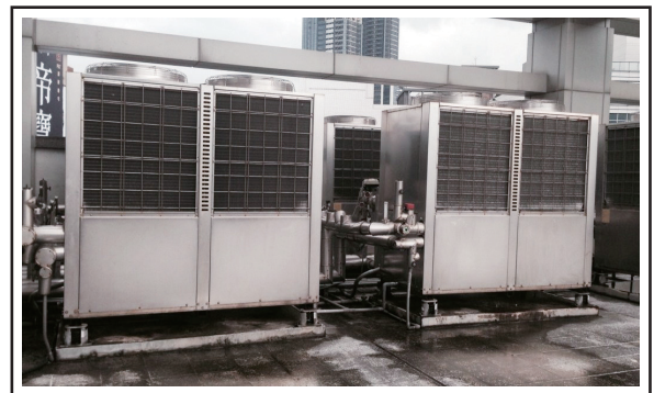
氣冷主機安裝YS-B彈簧式避振器
